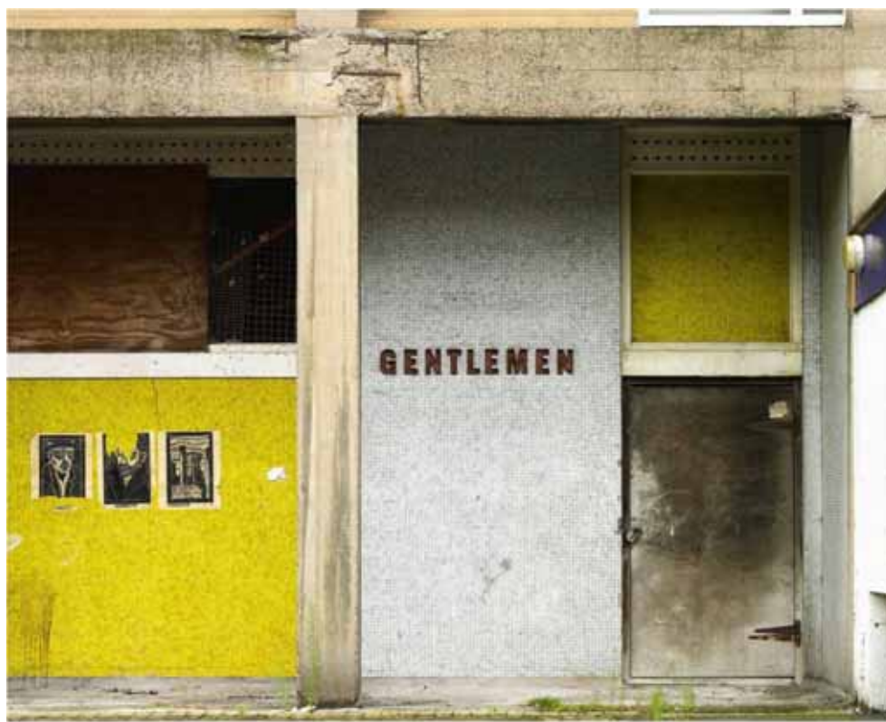
Figura 4.3 : Dettaglio dell'edificio pre intervento. Si noti il distacco del copriferro, ed il degrado complessivo del calcestruzzo.
