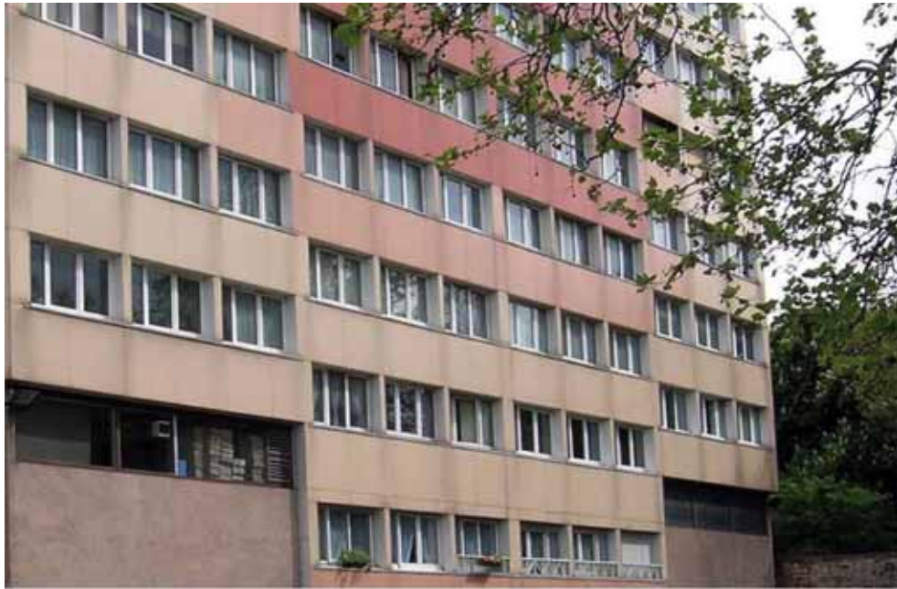
Figura 4.22 : 1. Dettaglio della facciata preesistente prima dell'intervento. 2. 3. Fasi di costruzione, successive allo smontaggio dei pannelli di rivestimento della facciata. 4. Vista complessiva della Torre durante i lavori di riqualificazione.
