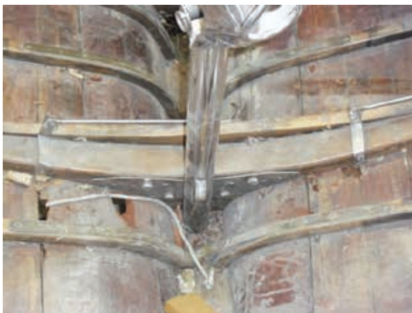
Uno dei madieri valutati non recuperabili a causa dei fenomeni di carie causati dall'ingresso di acqua piovana di ristagno attraverso i fori delle ferramenta del trasto della randa.
