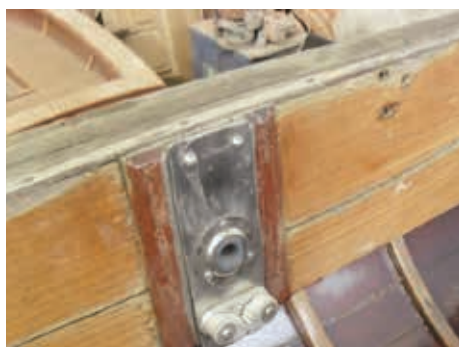
Il paramare di destra fessurato per la totalità della sezione resistente.
