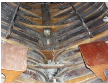
Gli strapuntini mobili del pozzetto sono evidenti segni di degrado limitatamente ai trattamenti superficiali di protezione.
