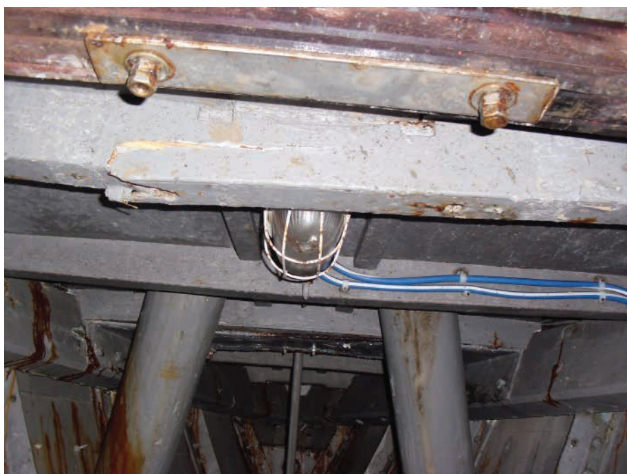
Figure 45 e 46. Deformazioni localizzate nella zona di coperta nei pressi di un grosso verricello dell'ancora. Lo sfondamento di una coppia di bagli ha portato all'appiattimento della bolzonatura del ponte che addirittura presenta un'inclinazione inversa, con formazione di ristagni d'acqua.
